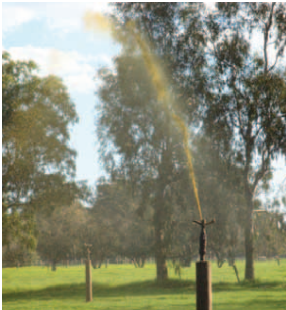
Sprinkler distributing effluent
